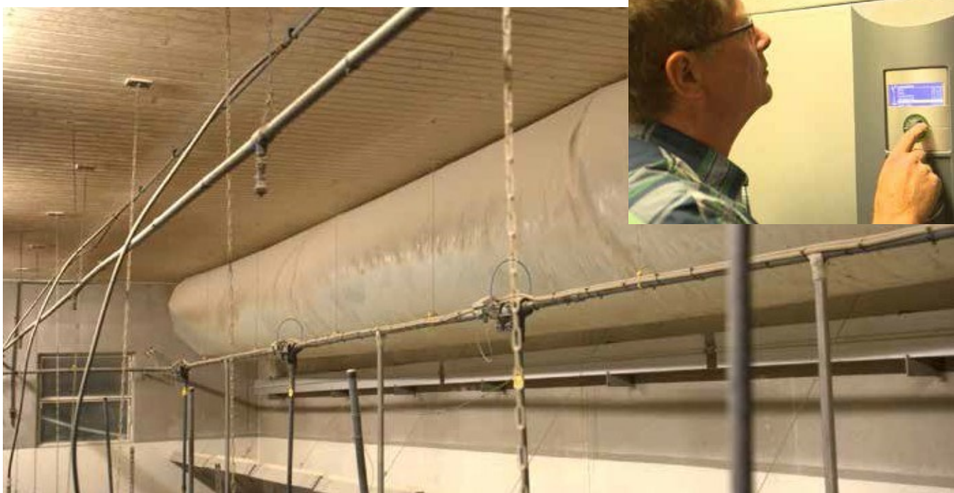
Controlo da temperatura na exploração de Timo Heikkilä, Finlândia
